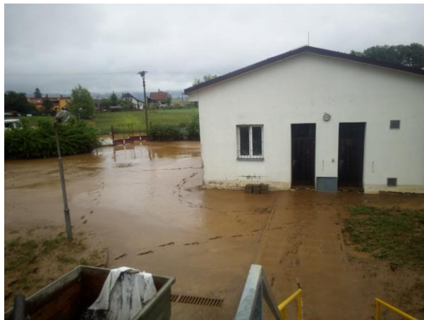
Povodní poškozená ČOV Šumvald (8.6.2020)
