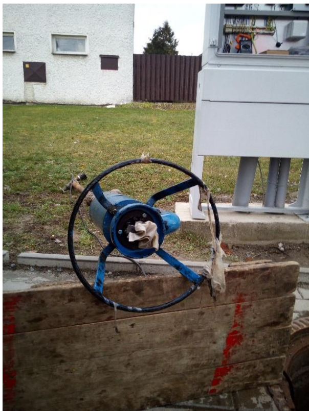
Zablokovaná čerpací stanice textilním ubrouskem v Dlouhé Louči
